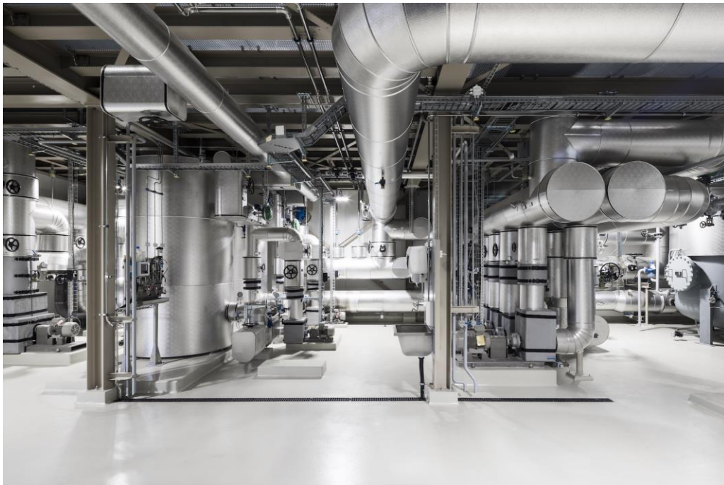
Bildlegende: So sieht die Heisswasserzentrale von innen aus.
